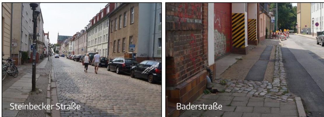
Abb. 2 Oberflächendefizite im Straßennetz mit Verkehrsaufkommen > 3 Mio. Kfz/a
