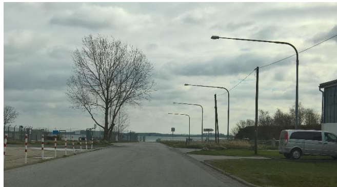
Abbildung 28: Alte Leuchten im Gewerbegebiet am Seehafen 104
