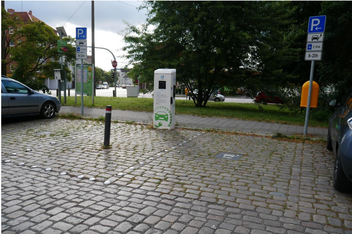
Abbildung 27 Barrierefreie Ladeinfrastruktur in der Stadt Kiel. Foto: privat
