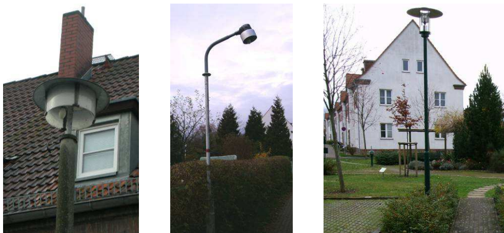
Abb. 48-50: Straßenbeleuchtung mit Rundscheiben-, Ansatz- und Zylinderaufsatzleuchten
