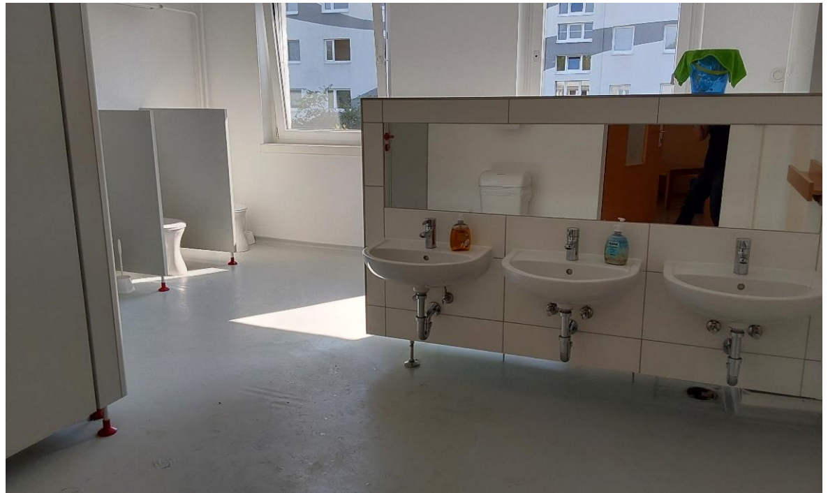
4 Bäder Kita Makarenko Restarbeiten ausstehend
